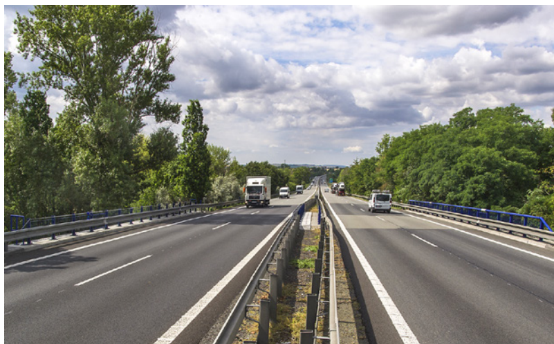
Obr. 7 Most na D-46 u Drysic ukazuje malý průřez produkcí svodidel OMO. Etapová oprava mostu přinesla drobnou zajímavost – čtyři typy svodidel jednoho výrobce na jednom mostě. Pohled směr Brno, zleva doprava typy: ZMS4-1/H2, MS4-1/H2, MS4/H2 a ZMS4/H2
