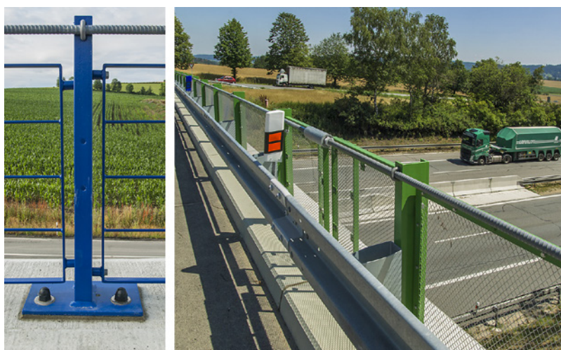
Obr. 5 Zábradelní mostní svodidlo ZMS4-1/H2 – most na D-48 u Hájova (2019) a most přes D-1 u Jiřic (2018)
